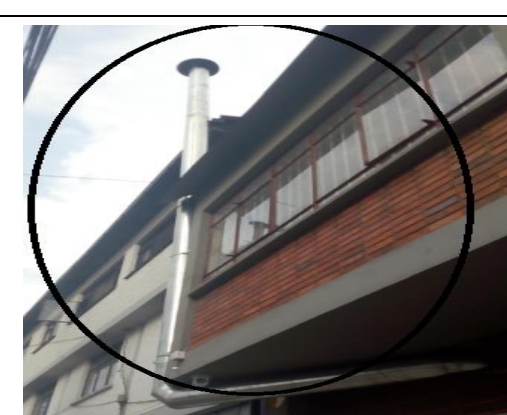
FOTOGRAFÍA 4. ASPECTO DEL DUCTO DE LA CALDERA DE 60 BPH QUE EMPLEA QUE ACPM PARA SU FUNCIONAMIENTO
