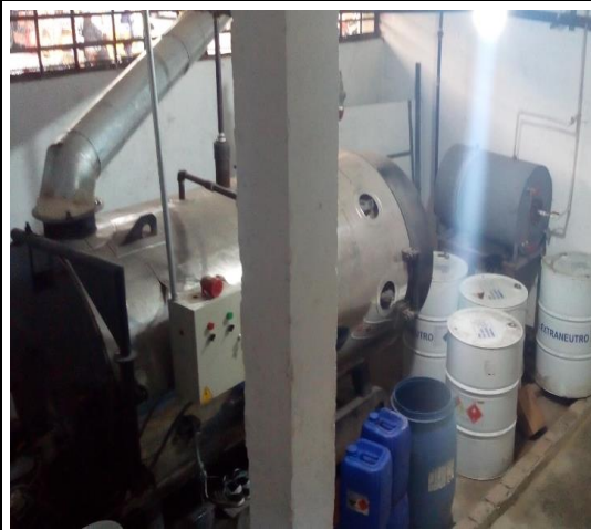
FOTOGRAFÍA 2. CALDERA DE 60 BPH QUE EMPLEA QUE ACPM PARA SU FUNCIONAMIENTO
